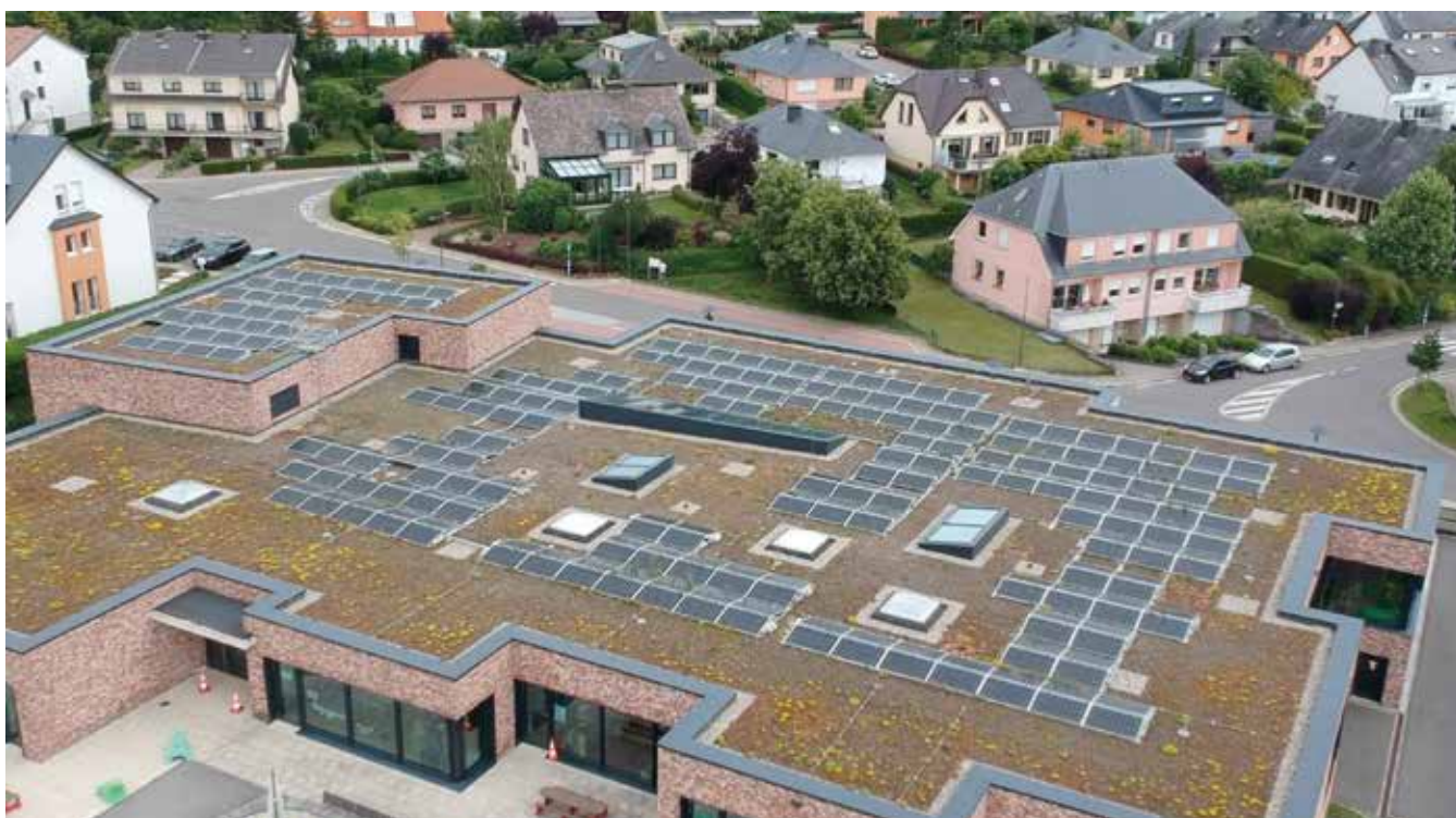
Energiegewinnung durch Sonne: Die Flachdächer kommunaler Gebäude werden nach und nach mit PV-Anlagen ausgerüstet. Production d'énergie grâce au soleil : les toits plats des bâtiments municipaux sont progressivement équipés de systèmes photovoltaïques.
